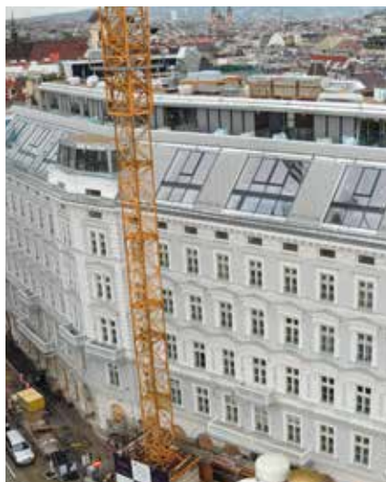
Restaurant, Hotel und Luxuswohnungen: Die Sans Souci Group zeigt mit der behutsamen Revitalisierung eines geschichtsträchtigen Gebäudes viel Fingerspitzengefühl.
