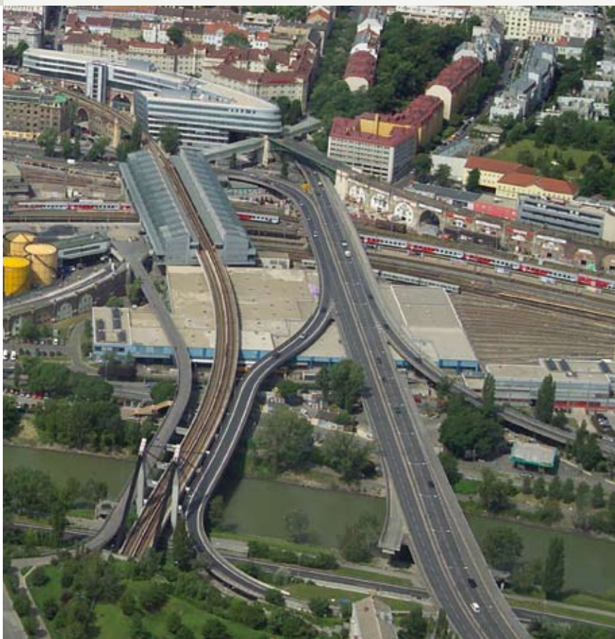
Nach 50 Jahren darf sich die Gürtelbrücke über eine dringend notwendige Instandsetzung freuen.
