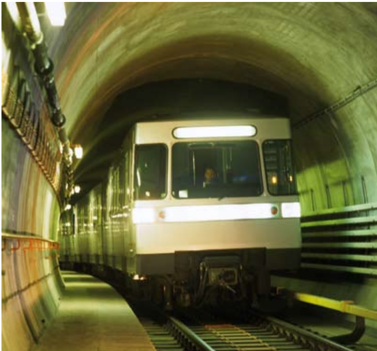
Gecelec und Wolek erneuern und warten elektrotechnische Anlagen und Fernmelderäume der Wiener U-Bahn-Stationen.
