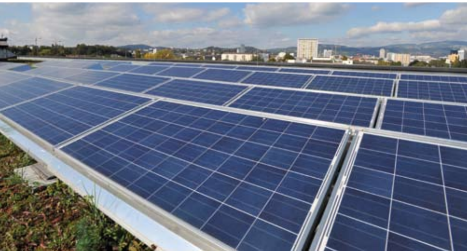
PV-Anlage auf dem Gebäude der Linz AG für eine Bürgerbeteiligungsanlage mit 200 Modulen Trina TSM-PC05-240W und 50 kWp – errichtet von Trina Solar mit dem österr. Partner my-PV.
