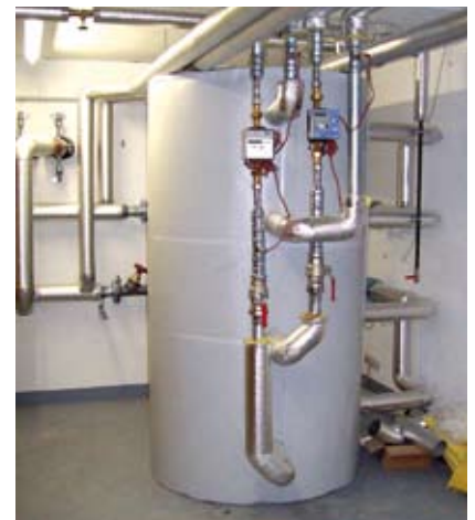
Pelletsanlage in Rabensburg, NÖ. 220 kW Leistung. Fernüberwachung, Betriebsführung, Wärmelieferung und Heizkostenabrechnung durch Energiecomfort.
