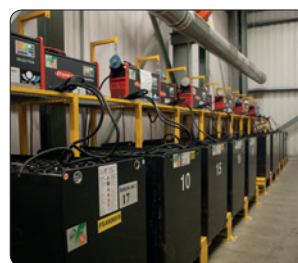
Für die Verfügbarkeit der Flotte sorgen 80-Volt-Wechselbatterien.
