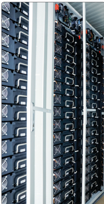
»Synerg-E«: Insgesamt zehn lokale Batteriespeicher werden bis Ende 2019 als stationäre Puffer bei Ultra-Schnellladestationen installiert.
