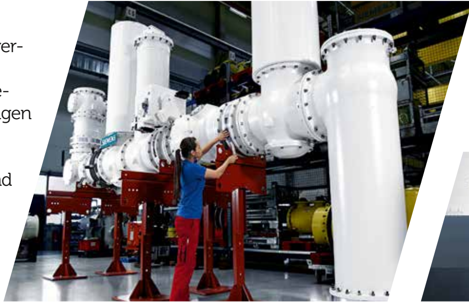
Die erste gasisolierte Kompakt-Schaltanlage für Hochspannungsgleichstrom-Anwendungen im Siemens-Schaltwerk in Berlin. Im typischen Aufbau besteht die DC-Schaltanlage aus den Komponenten Trennschalter, Erdungsschalter, Strom- und Spannungsmesssysteme, Kabel- sowie Verbindungsbausteine und Überspannungsableiter.
