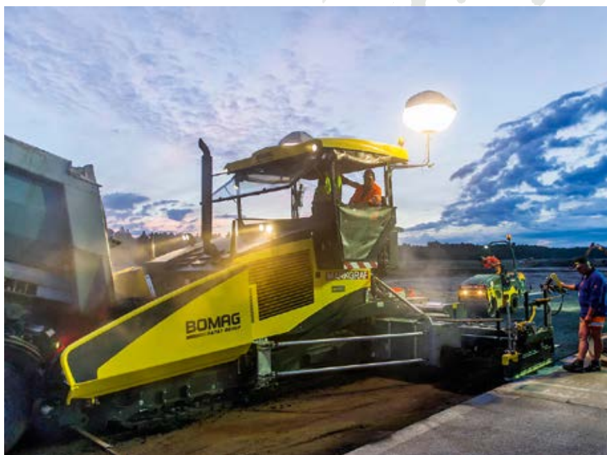
Die Nachtbaustelle am frühen Morgen: Der Bautrupps der W. Markgraf GmbH & Co KG beim Einbau der 14 cm dicken und 7,50 m breiten Asphalttragschicht.
