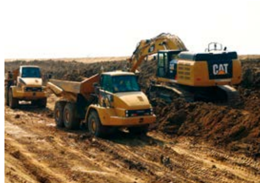
Beim Bau der Bahn-Umfahrung in St. Pölten vertrauen die Firmen Koller und Porr auf Muldenkipper und Bagger von Caterpillar.
