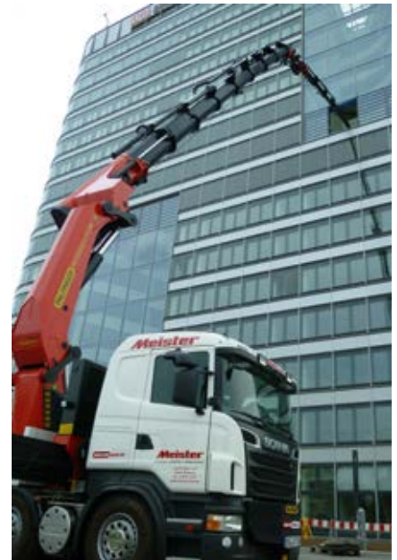
Der neue Langarmkran Palfinger PK 200002 L SH transportierte zielsicher etliche ausgewachsene Bäume auf 30 Meter Höhe in die neu angelegten Wintergärten eines Frankfurter Bürokomplexes.
