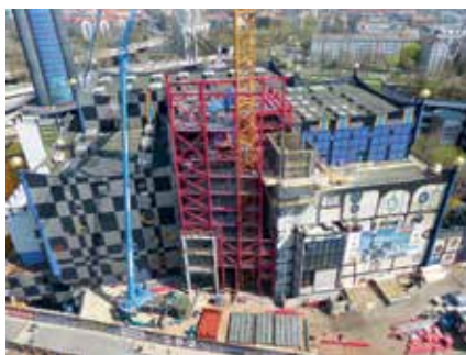
Die Züblin BaugesmbH ist maßgeblich an den Umbauarbeiten an der Müllverbrennungsanlage Spittelau beteiligt.
