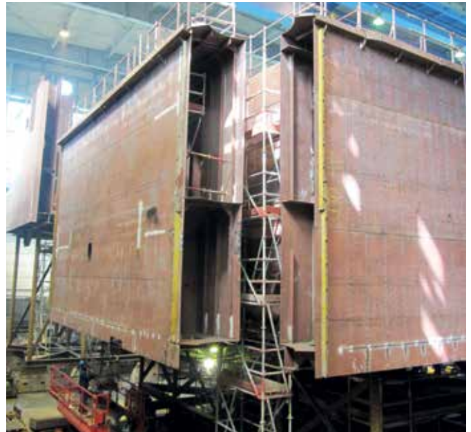
SCHWERGEWICHT. Die Umspannplattform für den Windpark Baltic 2 wiegt 4.000 Tonnen.
