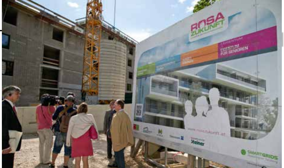
BAU DER WOHNANLAGE »ROSA ZUKUNFT«. Insgesamt 140, teilweise mit Gebäudeautomatisierung versehene Wohneinheiten und Garagenplätze für E-Cars.
