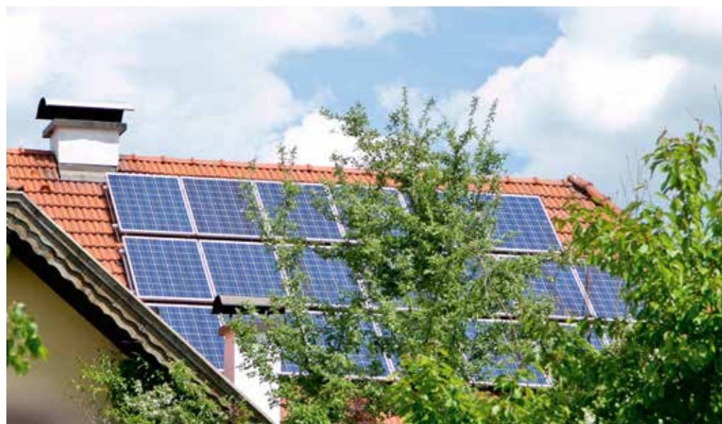
DER OUTPUT DER PV-ANLAGEN in Köstendorf wird in einer lokalen Trafostation gebündelt. Scheint die Sonne, werden gut 75 % des Strombedarfs abgedeckt.
