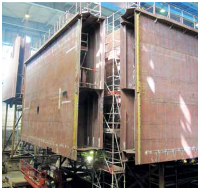
SCHWERGEWICHT. Die Umspannplattform für den Windpark Baltic 2 wiegt 4.000 Tonnen.
