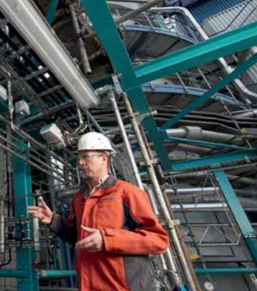
Blick ins Innere einer Pilotanlage zur CO 2 -Abscheidung aus Kohlekraftwerken mittels »Post Combustion Carbon Capture«.
